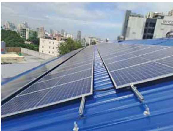
マカティYMCAホテル屋上のソーラーパネルの一部
