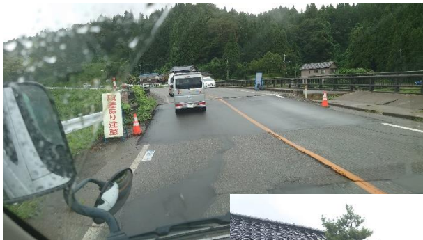
輪島市へ向かう道路 応急補修してあるが 段差でガタガタのまま
